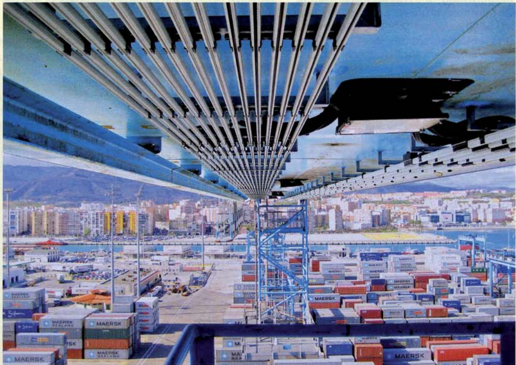
Am Maschinenhauskatzen-STS-Kran in Algeciras installierte Schienen zur Stromversorgung und Datenübertragung
