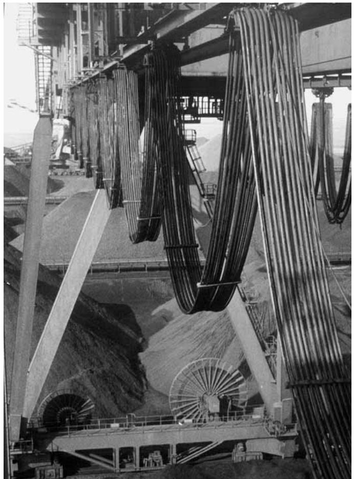
Sistema de Carros portacables con cables redondos en una instalación minera.
