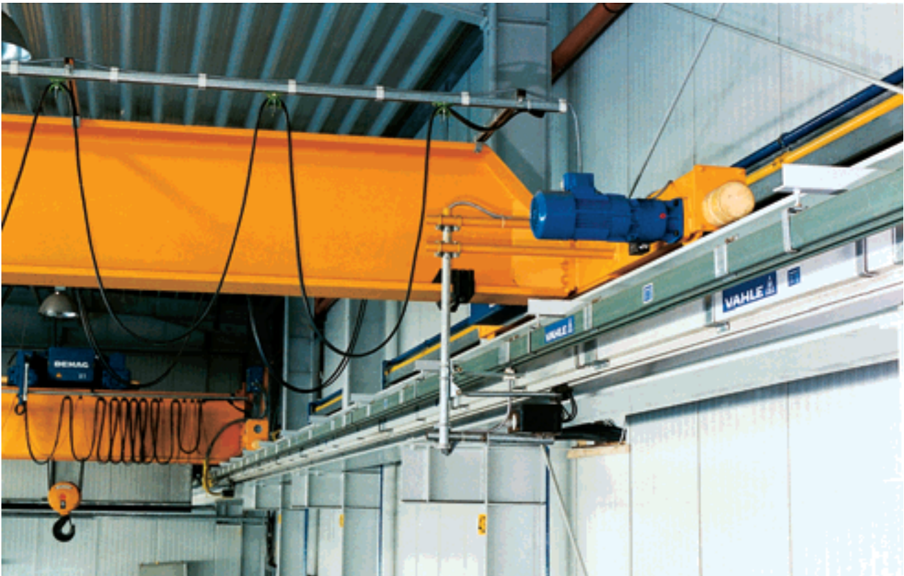
Conducción – KSL para Puente-Grúa en una Nave.
