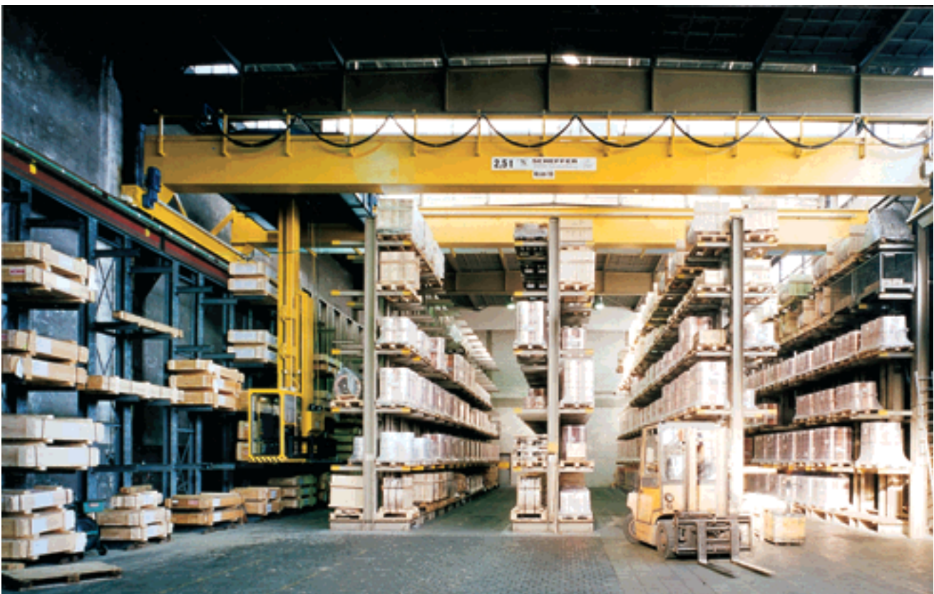
Conducción para Puente-Grúa apilador.
