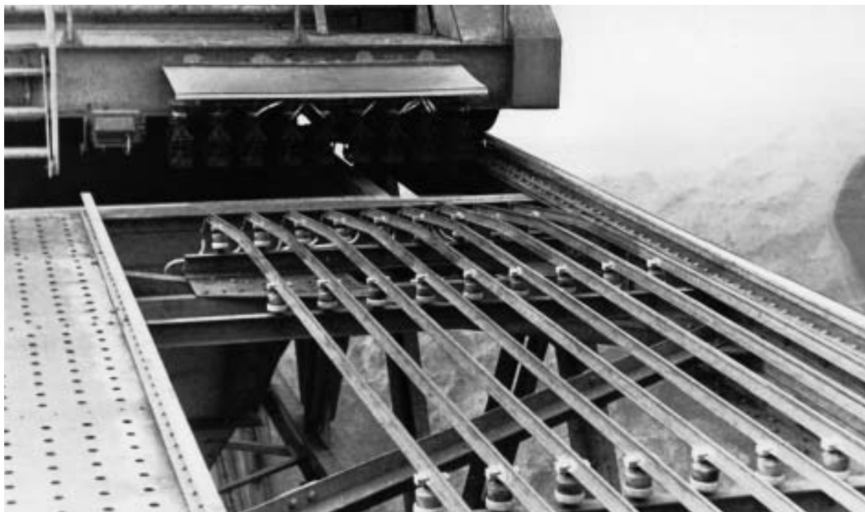
Puente grúa – disposición de una transferencia de conductores
