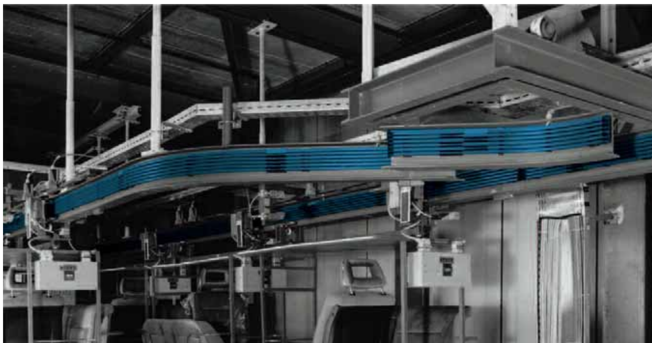
Carril unipolar aislado U 15, 6 polos, en una Electroavía con Cambios de vía en una fábrica de automóviles.
